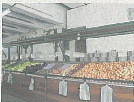
Viaduto da Lapa, onde funciona um sacolão, tem infiltrações nas paredes (Foto: Nathália Duarte/G1)
